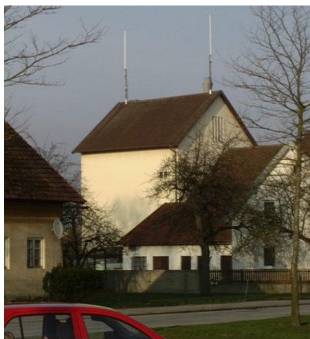
Abb. 1: Beispiel für eine Mobilfunksendeanlage mit omnidirektionalen Antennen.
